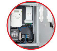
PLC-Zähler und PLC-Filter im Zählerkasten
